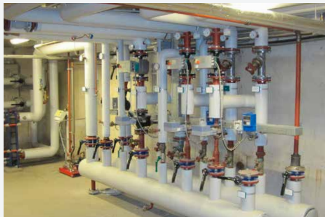
Installaties t.b.v. verwarming gebouw
